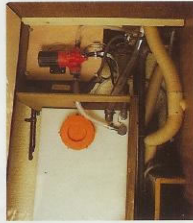
Tubi dell'acqua isolati e disposti all'interno.
