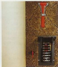
Scatola dei fusibili.
