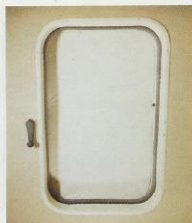
Oblio centrale con telo isolante e zanzariera.
