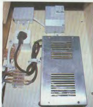
Ladegerät und Sicherungsautomat.
