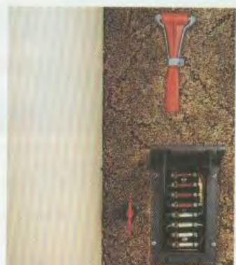
Sicherungskasten, Hauptschalter für Wohnraumelektrik.
